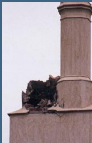
Daño producido por un rayo en Country St. Thomas, Canning, Ezeiza.
